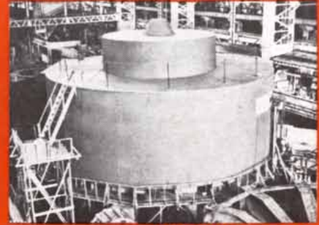
143,750 KVA AC Generator
