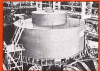
143,750 KVA AC Generator
